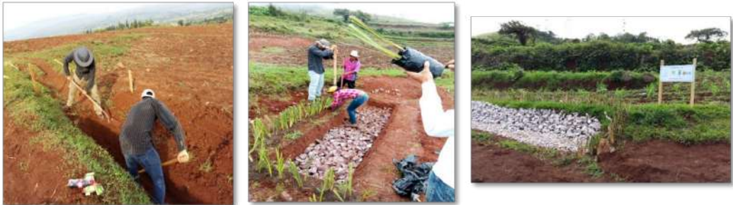
Figura 6: . Proceso de construcción de las galerías. Fuente: Foto propia para el estudio
